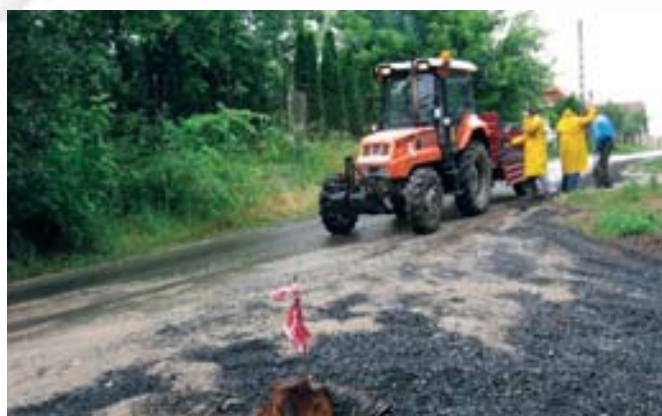
Az elmosott útpadkák javítása Sződ-Nevelek településrészben
